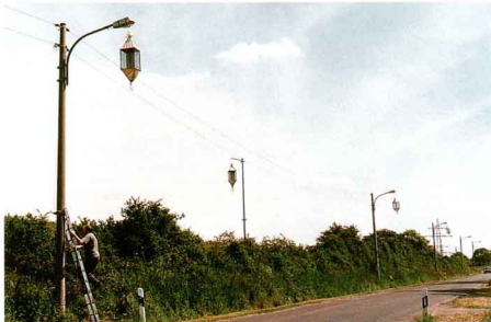
Abb. 3: Leuchtmasten entlang der Kreisstraße bei Sulzheim, bestückt mit Netzektoren. Der Mast in der Bildmitte diente ohne Lampe als Kontrolle.
